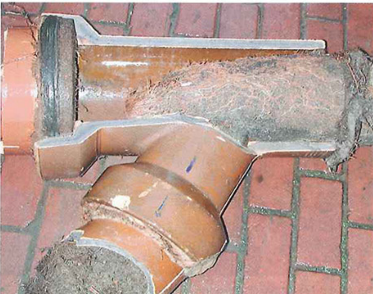
Wurzeleinwuchs in einen Abwasserkanal. © IKT
