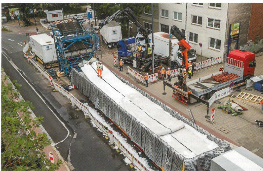
Bild 1: Bremens größter Schlauch: Einbau eines Synthesefaserliners (Länge 130 m, Durchmesser 2,20 m, Dicke 5 cm) in das 1913 gemauerte und zwischenzeitlich sanierungsbedürftige Maulprofil in der Finddorfstraße
