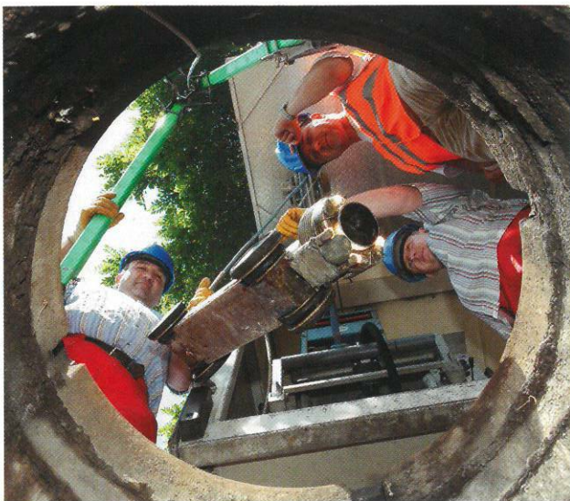
Bild 3: Prüfsingenieure der Gütegemeinschaft Kanalbau unterstützen die gemeinsamen Qualitätsziele der Vertragspartner durch Baustellenbesuche
