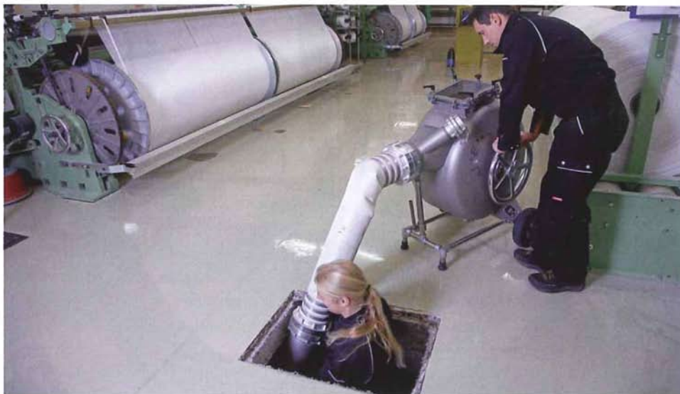
Professionelles Arbeiten unter laufendem Betrieb: Bei der grabenlosen Sanierung bleibt die Bodenplatte unverändert, so dass teure und langwierige Wiederherstellungsarbeiten komplett entfallen. | Foto: Brawoliner
