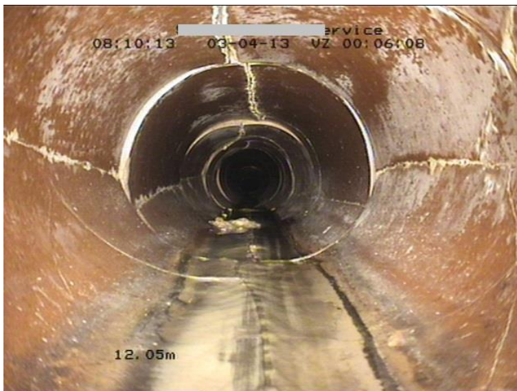
Bild 8: Gefahr des Einsturzes bei Durchführung von Fräsarbeiten
