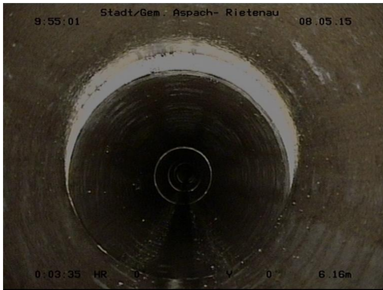
Bild 9 Undichte Rohrverbindung mit Versatz
