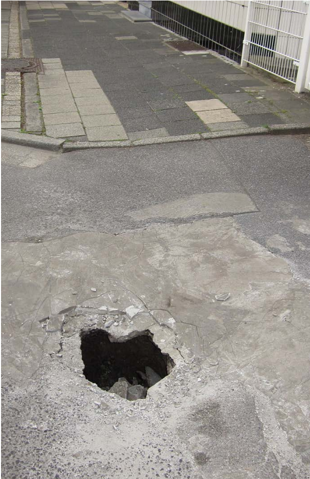
Bild 8: Tagbruch durch defekte Anschlussleitungen
