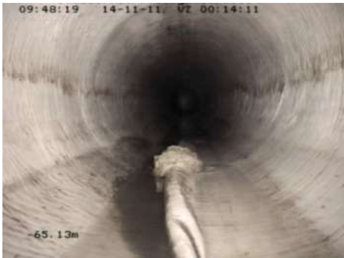
Bild 4: Längsfalte im Schlauchliner
